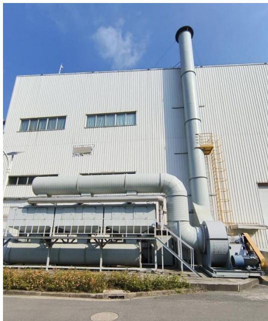
VOCs 治理系统
